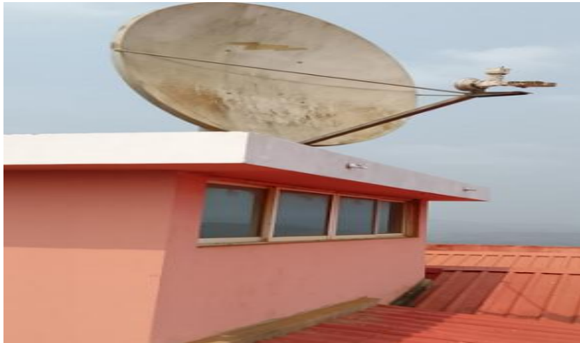
FIGURA 3: Terminal VSAT já existente na delegação
